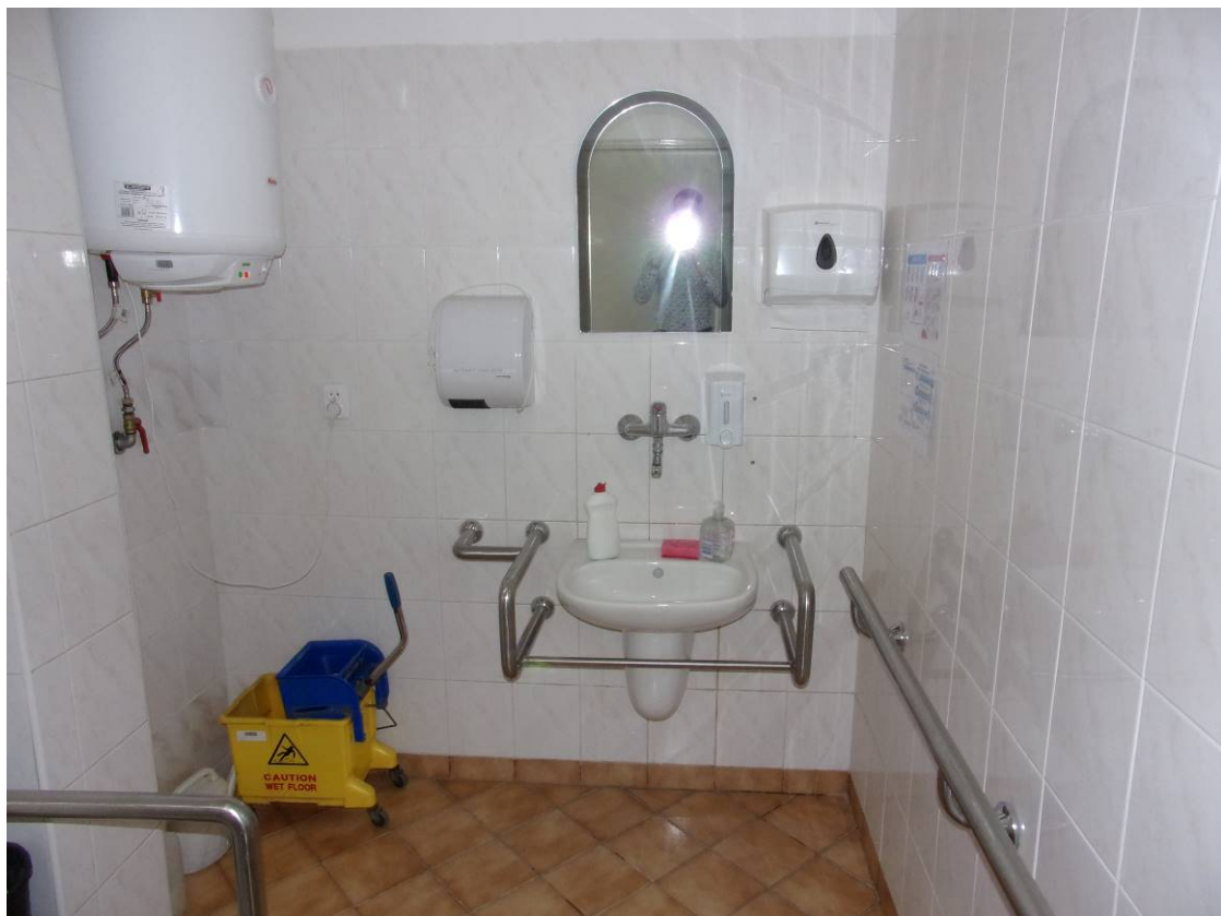
Fot.nr 1, 2: WC dla osób z niepełnosprawnościami
